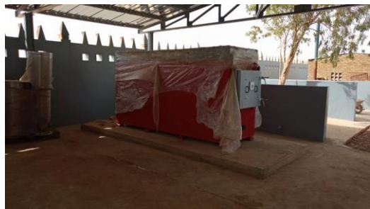
Figure 14 : Site d'incinération/Hôpital Mopti
